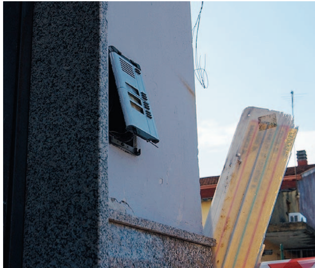
Il citofono divelto del Centro d'accoglienza in Via dei Bizantini a Lamezia
